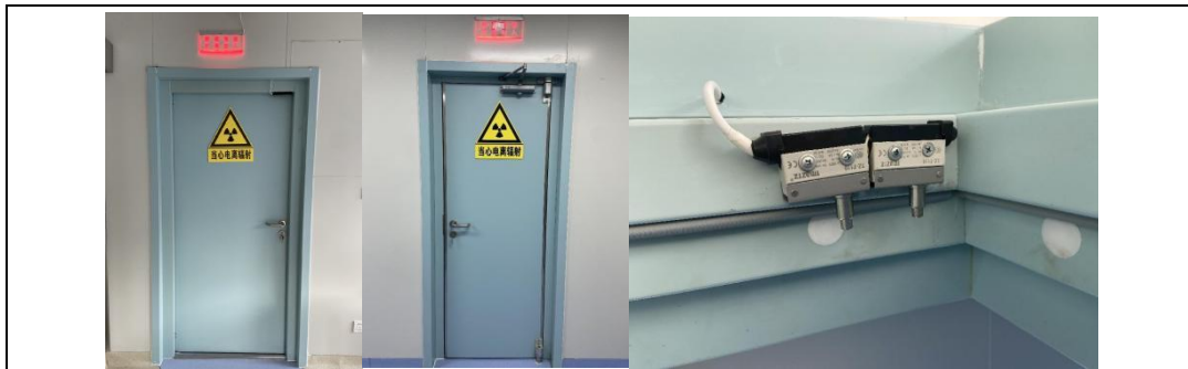
机房门及控制室门外警示标识、工作状态指示灯、门机联锁等
